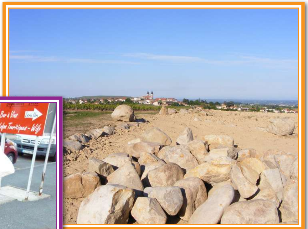
Une vue du site en cours d'aménagement par les établissements Loron. Cliché Patoune.
